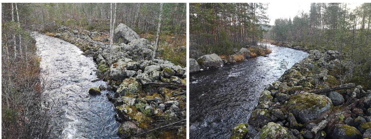
Bild 4-5. Uppschaktade vallar längs sträcka 1A som stänger av den naturliga bredden och kanaliserar vattendraget.
