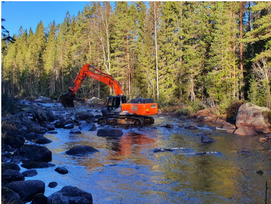
Bild på grävmaskin som återställer en sträcka av Ängerån i Ljusdals kommun, Gävleborgs län. Foto: Anders Persson, Länsstyrelsen Gävleborg
